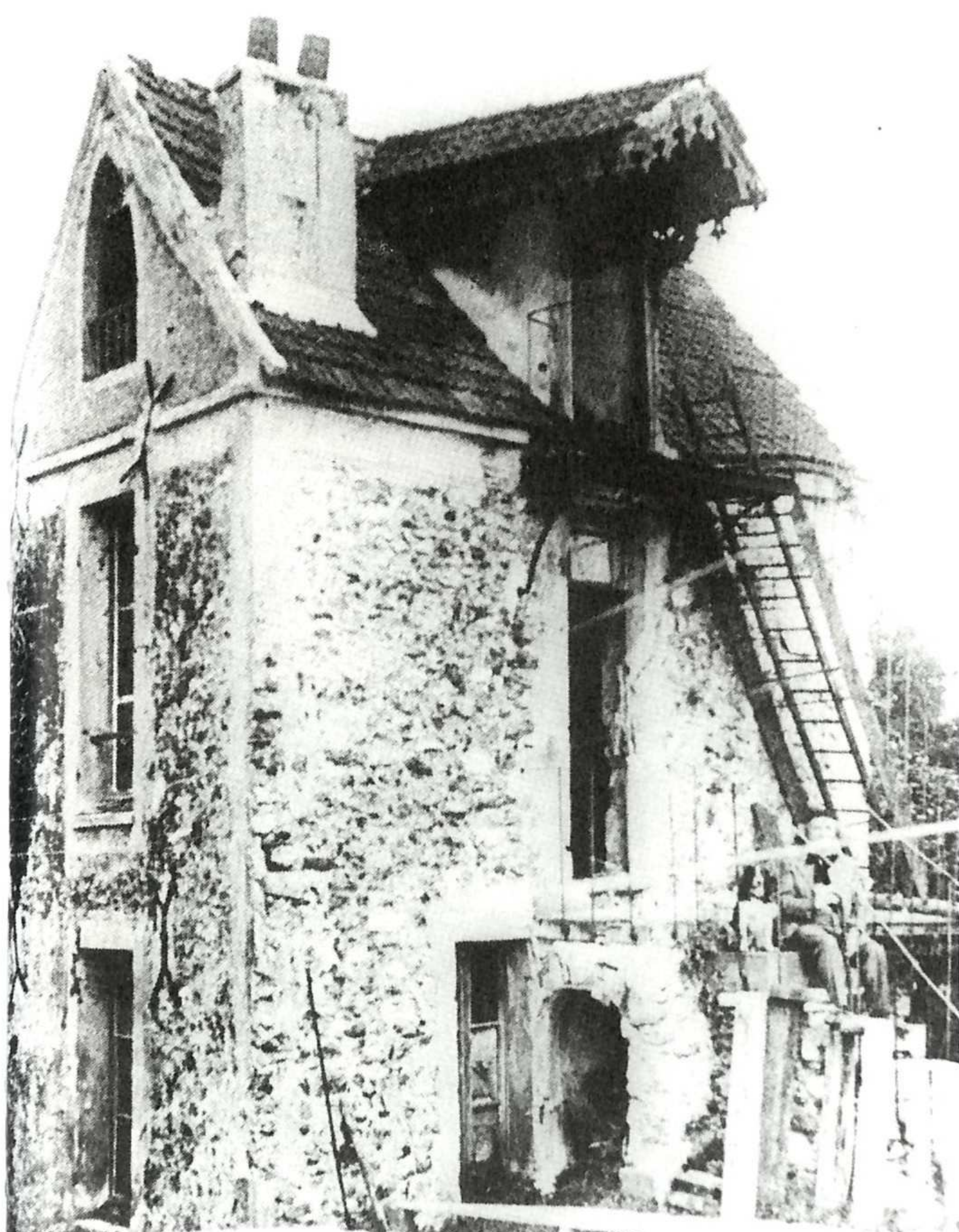
La maison en ruines.
